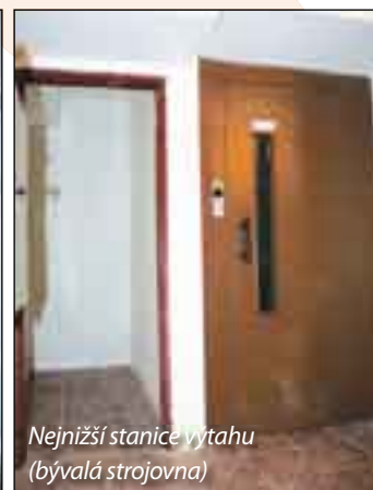
Pohled do strojovny výtahu v suterénu
