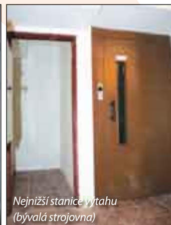
Pohled do strojovny výtahu v suterénu
