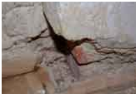
Obr. 1 Poškozená zeď prohrabaná až na cihlu
