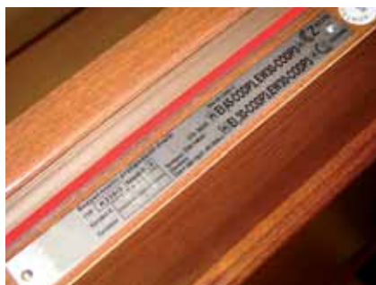
Štítek na bezpečnostních protipožárních dveřích.
