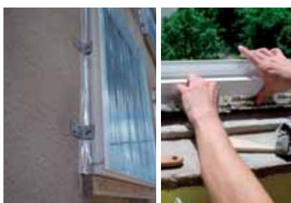
Obr. 1: Kotvení oken probíhá stejným způsobem jako u pasivních novostaveb. Okna jsou v ideálním případě předsazena až do vrstvy izolace kvůli eliminaci tepelných mostů. Důležité je také neprůvzdušné napojení rámu okna na konstrukci pomocí speciálních pásek nebo lišt. (Zdroj CPD, Solanova Consortium)
